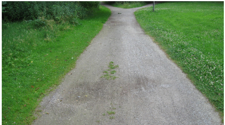
Rad- und Fußweg Frielingsen - Zustand der Fahrbahnoberfläche
