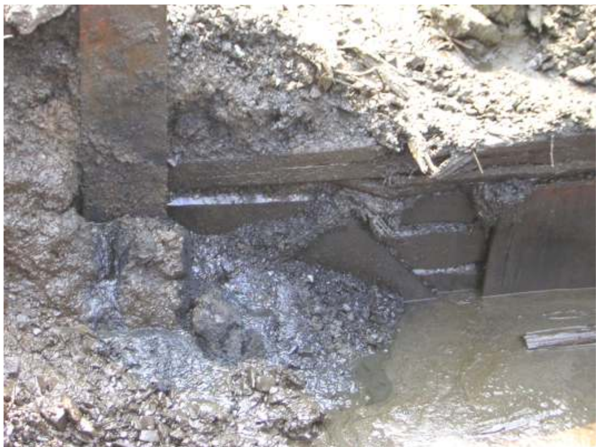
Abbildung 7: Austrittsstelle von Mineralöl-Kohlenwasserstoffen im Abbruchfeld
